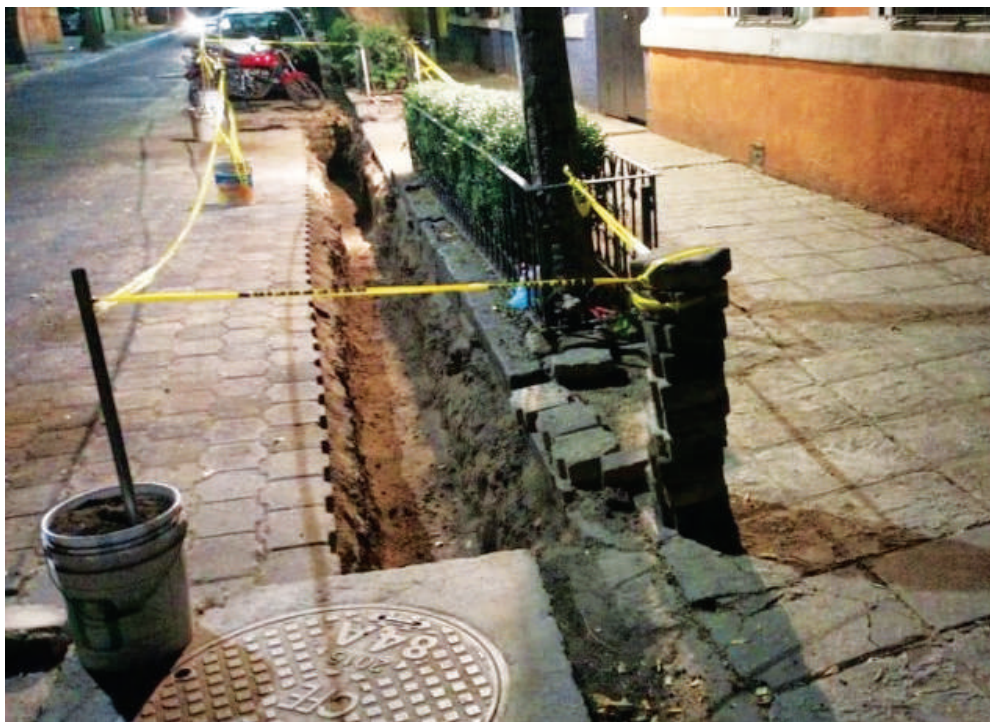
Figura 10.2. Canal abierto en el arroyo vehicular que afecta a los vecinos
